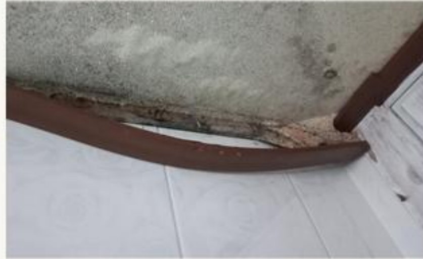
누수로 휘어진 마감재(샤워실 천장)
